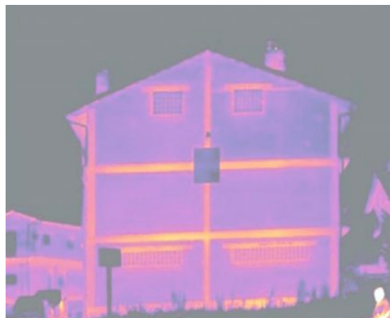
Termografía de vivienda sin aislar los puentes térmicos. Las zonas más rojas, indican pérdidas de calor por no controlar los puentes térmicos. Esto con el sistema SATE se reduce de manera considerable.
