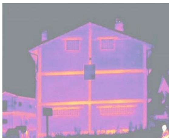
Termografía de vivienda sin aislar los puentes térmicos. Las zonas más rojas, indican pérdidas de calor por no controlar los puentes térmicos. Esto con el sistema SATE se reduce de manera considerable.
